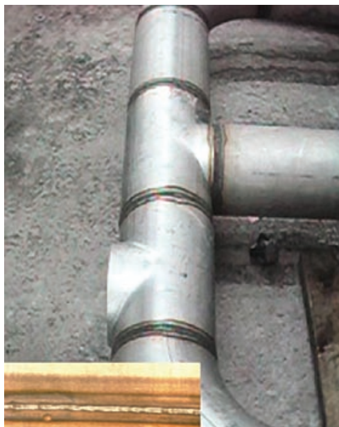
Przebarwienia po spawaniu na powierzchni stali odpornej na korozję muszą zostać usunięte stosując proces trawienia w celu przywrócenia powierzchni stali pożądanej odporności korozyjnej. Zdjęcie: Nickel Institute
